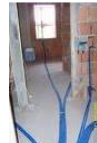
Impianti interni in opera
